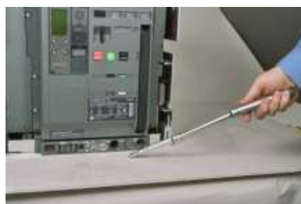
Racking Handle Extended Einfahrkurbel auseinander gezogen Korba wsuwania po rozciagnieciu
