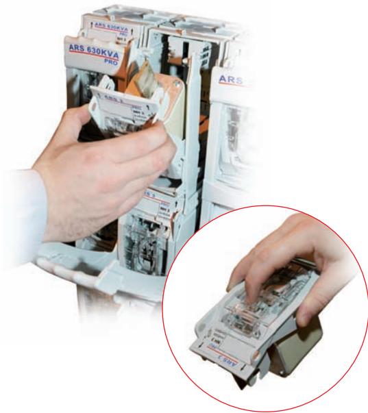
wymiana wkładek bezpiecznikowych
