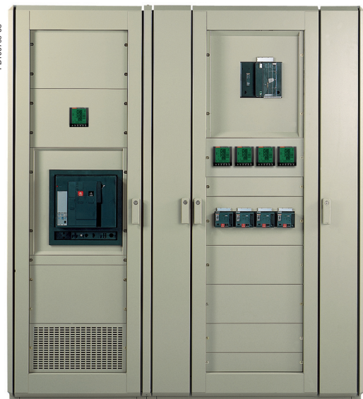
Rozdzielnica główna NN
