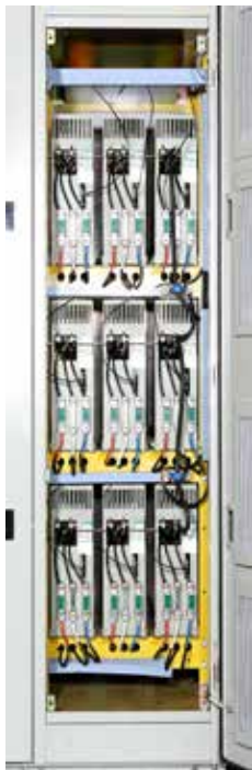
Szafa komórek mocy
