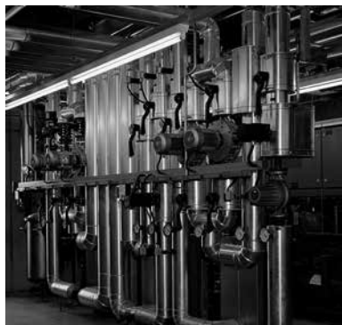
ATV 12 sterowanie stacji pompowej
